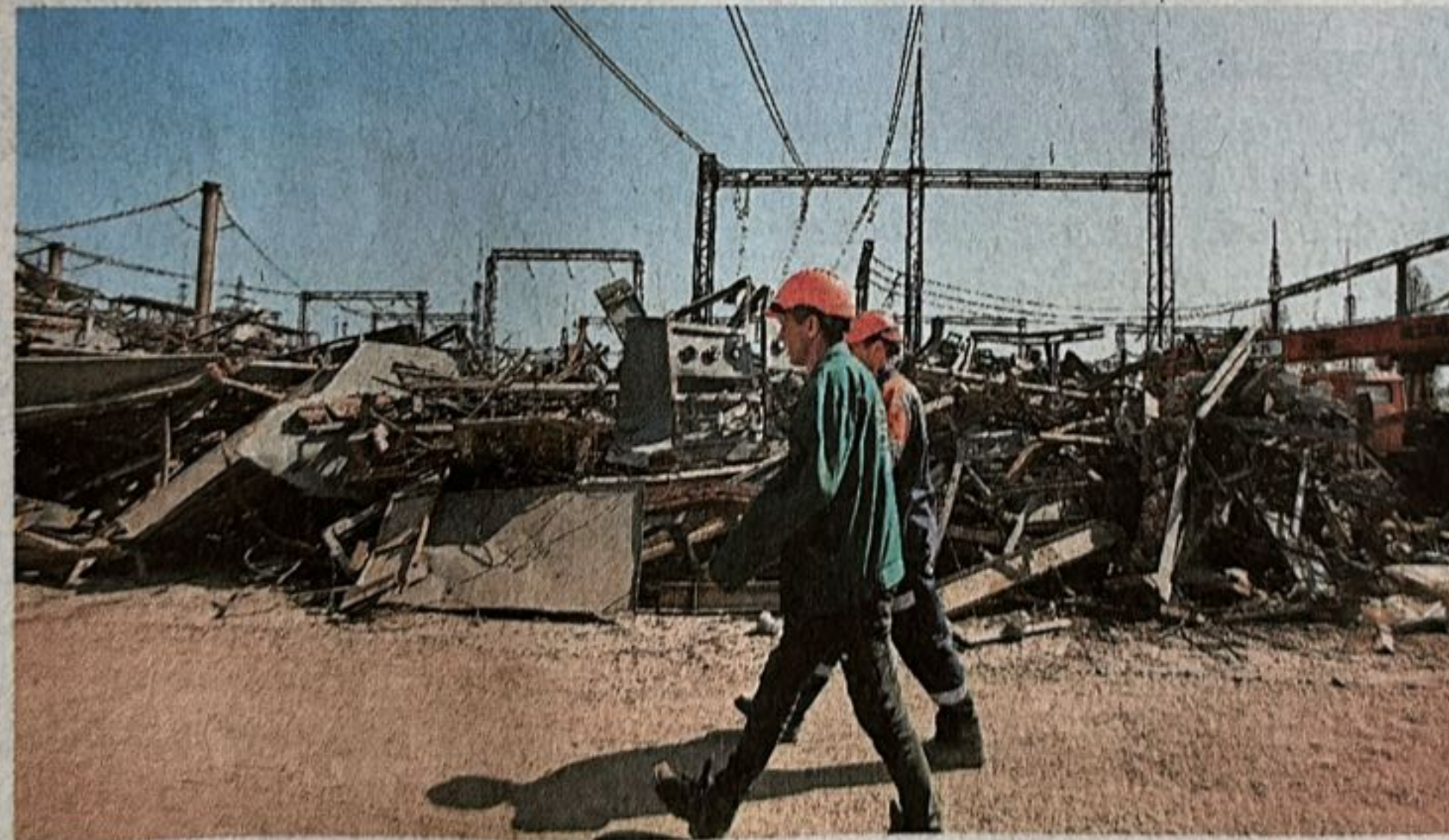
Arbeiter eines Versorgungsunternehmens vor den Trümmern einer durch russischen Beschuss beschädigten Energieanlage in Charkiw. Die Hilfe aus Nürnberg war und bleibt überlebenswichtig. Foto: Ukrinform/dpa
